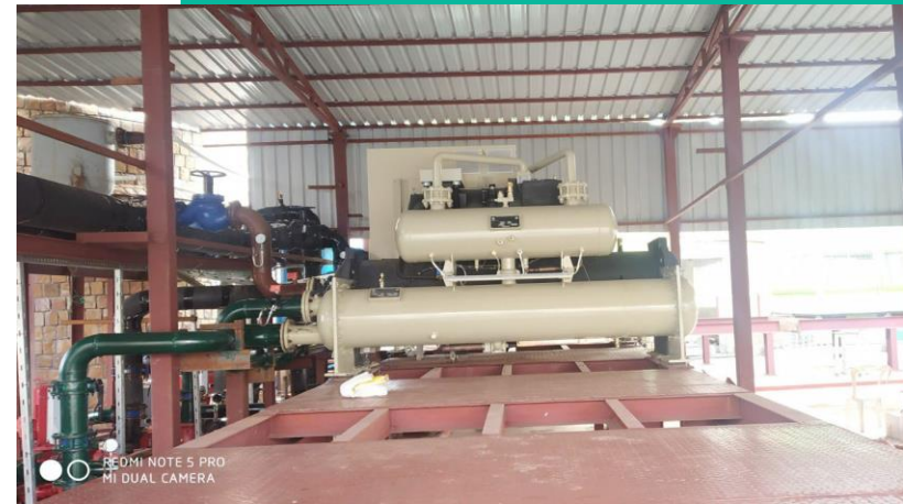
ការបង្ហាញចំហាយ ដោយ screw chillers ជាមួយ VFD
